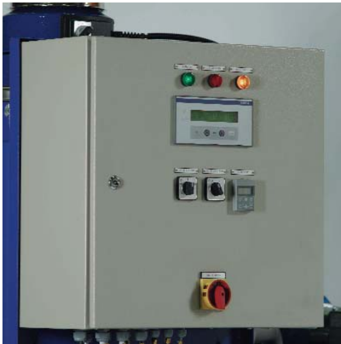
Schaltschrank mit bedienerfreundlichem Tastenfeld der SPS.
